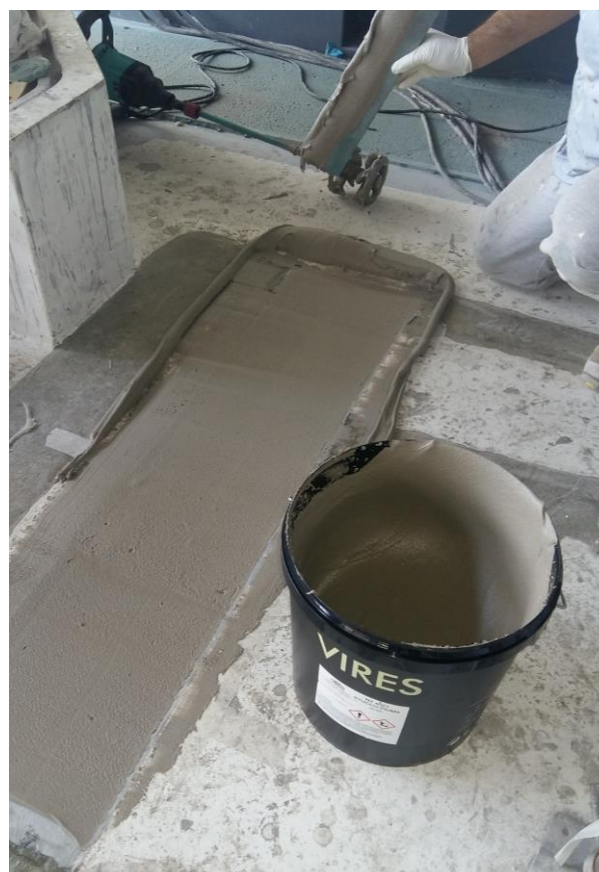
Applicazione a bordo nave / On board application
